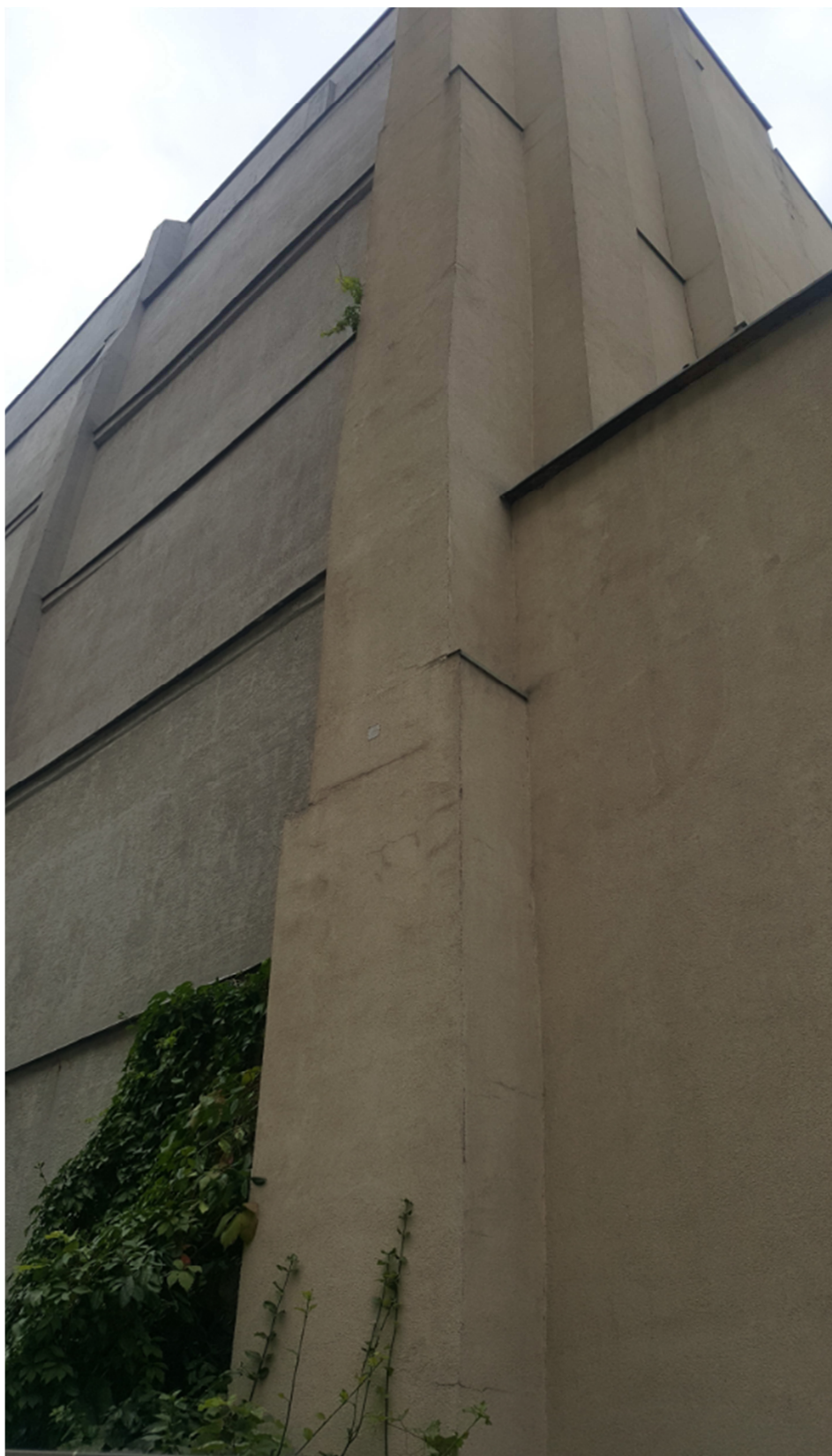
Fot. 5. Elewacja budynku od strony zachodniej, widok na granice budynków między Sienna 82 i Żelazną 43
